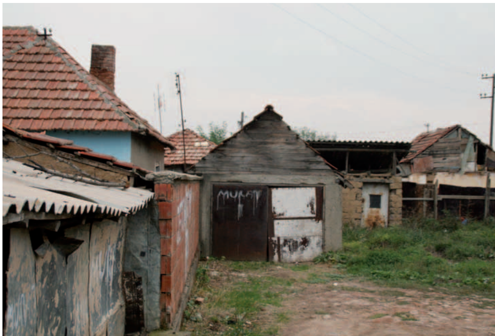
Roma-Siedlung Fushe Kosova. Die engen, oft vom Verfall gekennzeichneten Hütten sind nicht dafür ausgelegt, abgeschobene zusätzliche Familienmitglieder aufzunehmen.
